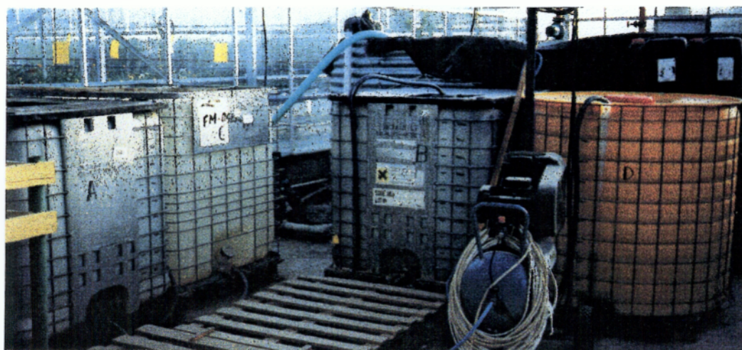
Εικ. 8 Δεξαμενές πυκνών διαλυμάτων
