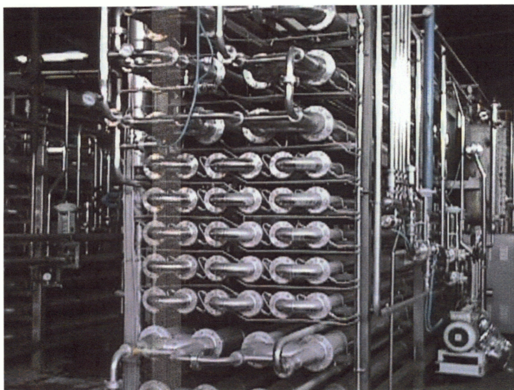
Εικ.11 ΑΣΗΠΤΙΚΟ ΜΗΧΑΝΗΜΑ
