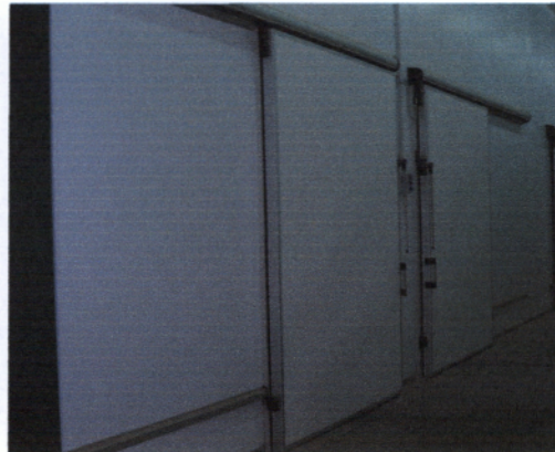
Εικόνα 5.2 Θάλαμος ψύξης εξωτερικά.
