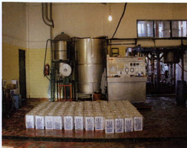
Εικόνα 2.21: Ανοξείδωτη δεξαμενή συντήρησης του χυμού και δοχεία αποθήκευσης χυμού [ΣΤΑΜΠΕΛΟΣ 1999]
