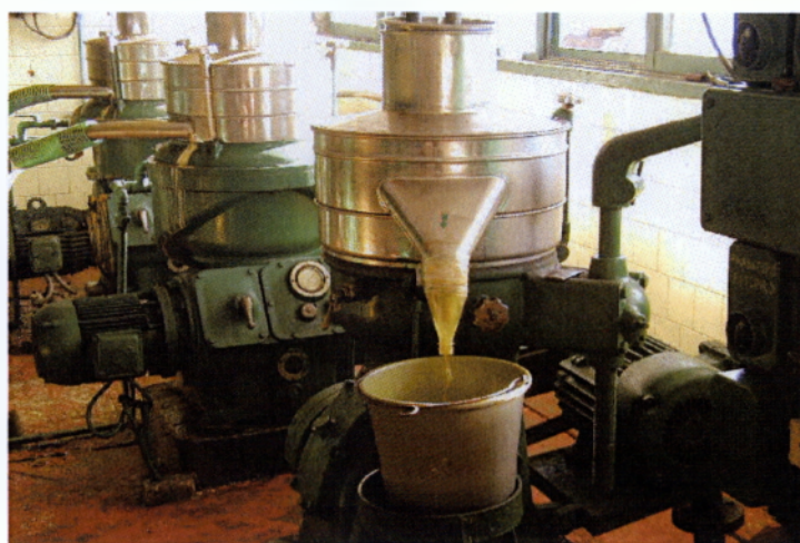
Εικόνα 2.23: Διαχωριστήρες αιθέριου ελαίου, δύο Delaval UVPX-207-00A (στο βάθος) και ένας Delaval A-19 (εμπρός), [ΣΤΑΜΠΕΛΟΣ 2004]
