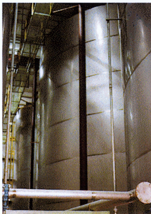
Εικόνα 2.29: Ασηπτική ανοξείδωτη δεξαμενή NFC χυμού [ENERFAB]
