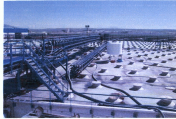
Εικ. 2.5: Σωληνώσεις για μεταφορά άλμης και ελιών
