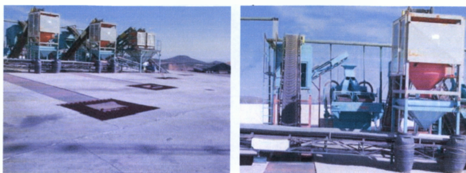
Εικ. 2.10: Εγκατάσταση παραλαβής, καθαρισμού και ζύγισης των καρπών
