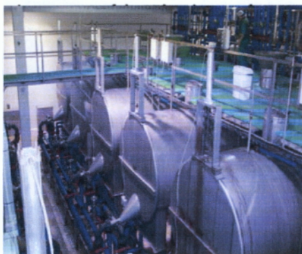
Εικ. 2.22: Δεξαμενές από ανοξείδωτο χάλυβα για την οξείδωση ελιών
