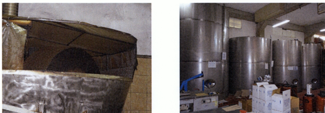
Εικόνα. 17 Ελαιοτριβείο Σκαρπαλέζου. Α. Ελαιοτριβείο για την παραγωγή άθερμου λαδιού . Β. δεξαμενές αποθήκευσης. (προσωπικό αρχείο).
