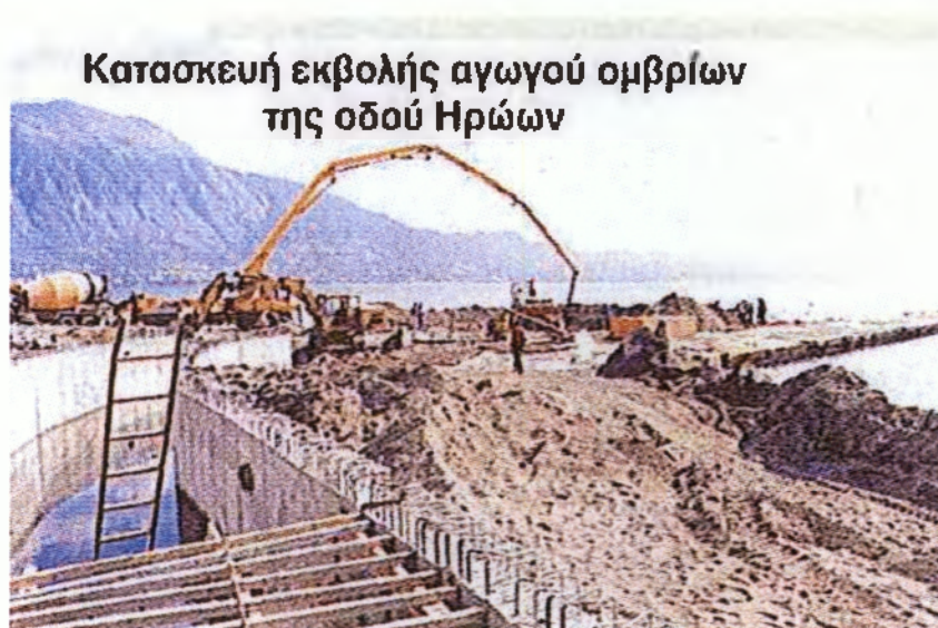
Εικόνα 4: Αγωγός Ομβρίων στην οδό Ηρώων
