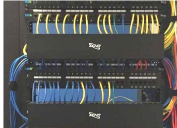
Εικόνα 7: Μεικτονόμηση Τηλεφωνικού PatchPanel.
