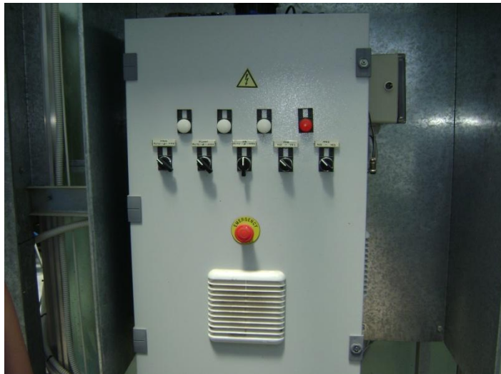
Εικόνα: Ηλεκτρικός πίνακας ελέγχου της λειτουργίας του συστήματος επιπλεύσεως
