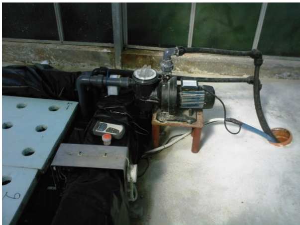
Εικόνα: Αντλία επανακυκλοφορίας.
