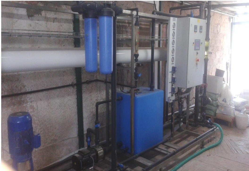
Σύστημα αφαλάτωσης νερού με αντίστροφη ώσμωση
