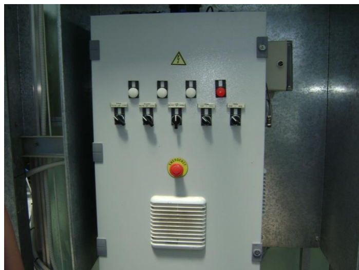
Εικόνα 1.2.3.2.1: Ηλεκτρικός πίνακας, ελέγχου λειτουργίας floating, υδρονέφωσης και ανεμιστήρων.
